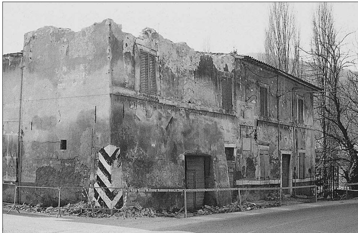
Fig.44 Casenove, effetti delle scosse del settembre-ottobre 1997 su un vecchio edificio: è ancora rilevabile uno sperone di rinforzo, oggi verniciato in bianco e nero, realizzato come intervento di consolidamento dopo il terremoto del 1791.
