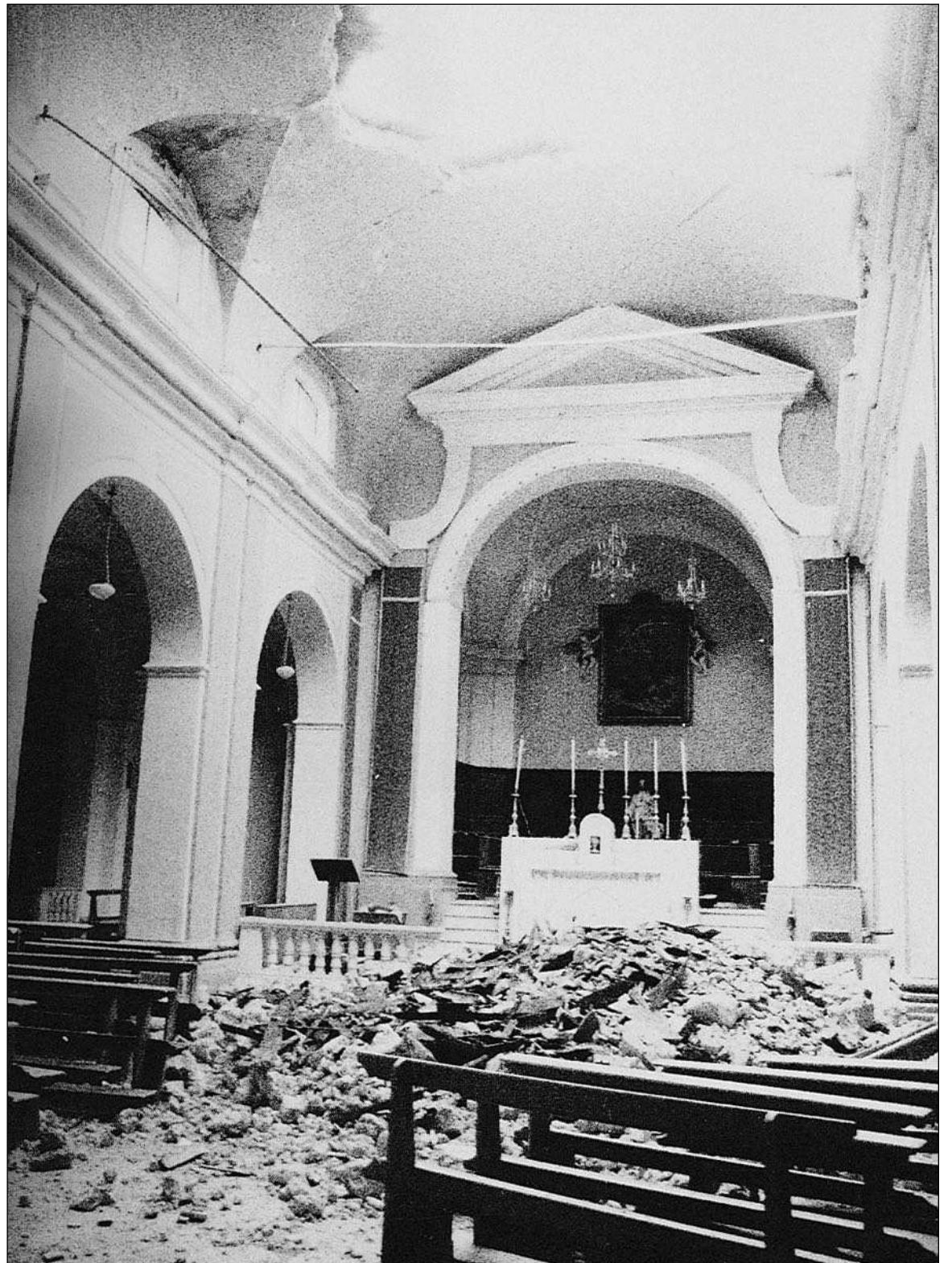
Fig.99 Terzone San Pietro (Rieti): il terremoto del 19 settembre 1979 colpì anche l'Appennino reatino, di cui nel testo non sono riportati gli effetti. Qui è documentato il crollo della navata centrale della chiesa di San Pietro in Cellis.
