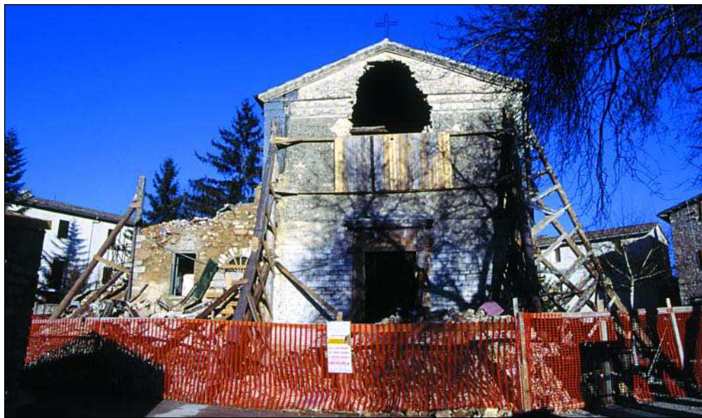
Fig.48 Villa Magina, chiesa parrocchiale: crolli parziali e puntellamenti a causa delle scosse del settembre-ottobre 1997. Questo edificio subì gravi danni anche per il terremoto del 1791.
