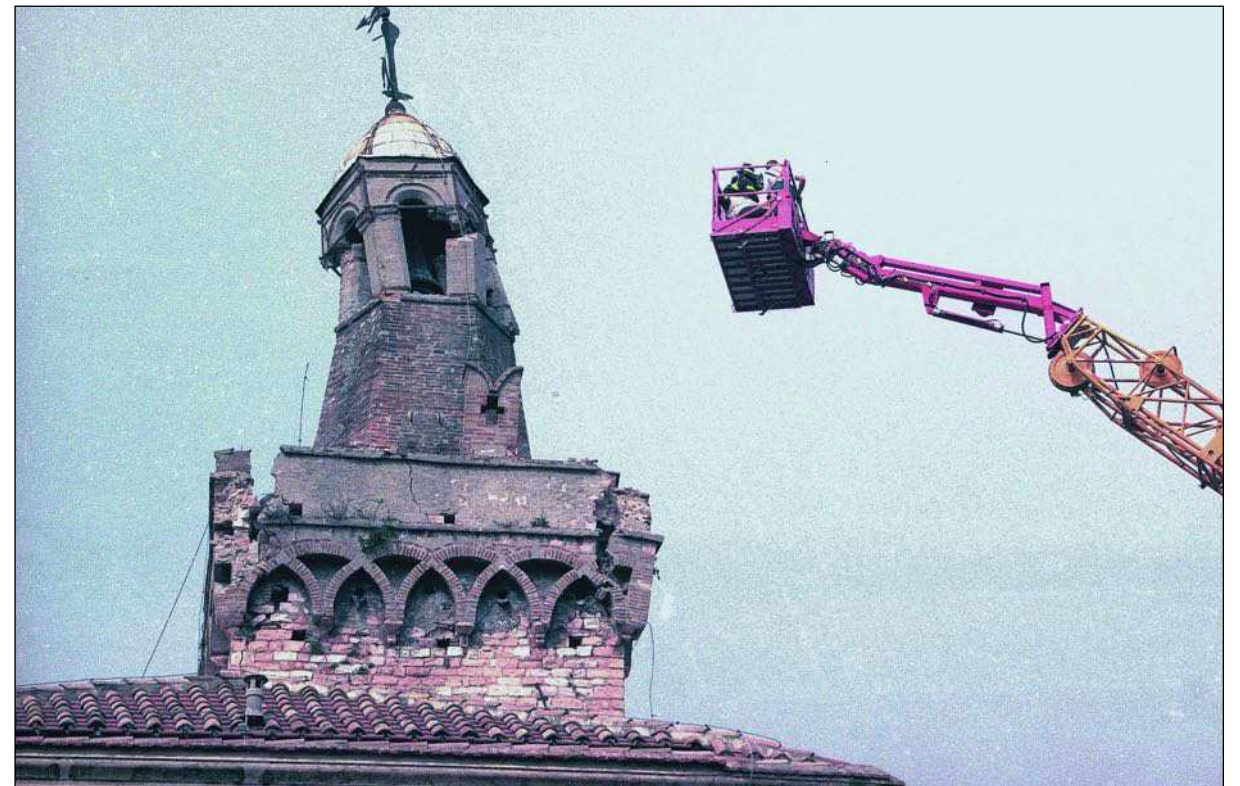
Fig.112 Foligno: il “Torrino”, la torre campanaria alla sommità dell'edificio comunale, prima del crollo totale.
