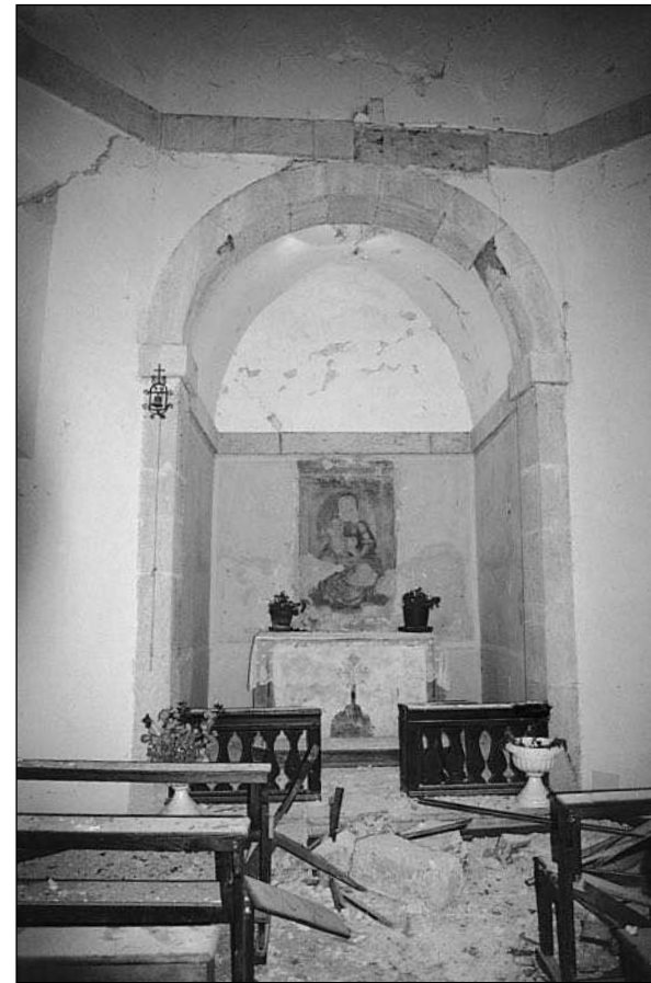
Fig.42 Sellano, chiesa di San Francesco: gli effetti subiti per le scosse del settembre-ottobre 1997 appaiono molto simili a quelli causati dal terremoto del 1791, descritti dagli architetti pontifici in una dettagliata perizia.
