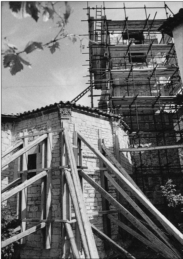
Fig.95 Legogne, chiesa di San Martino: l'abside e il campanile puntellati dopo il terremoto del 19 settembre 1979.
