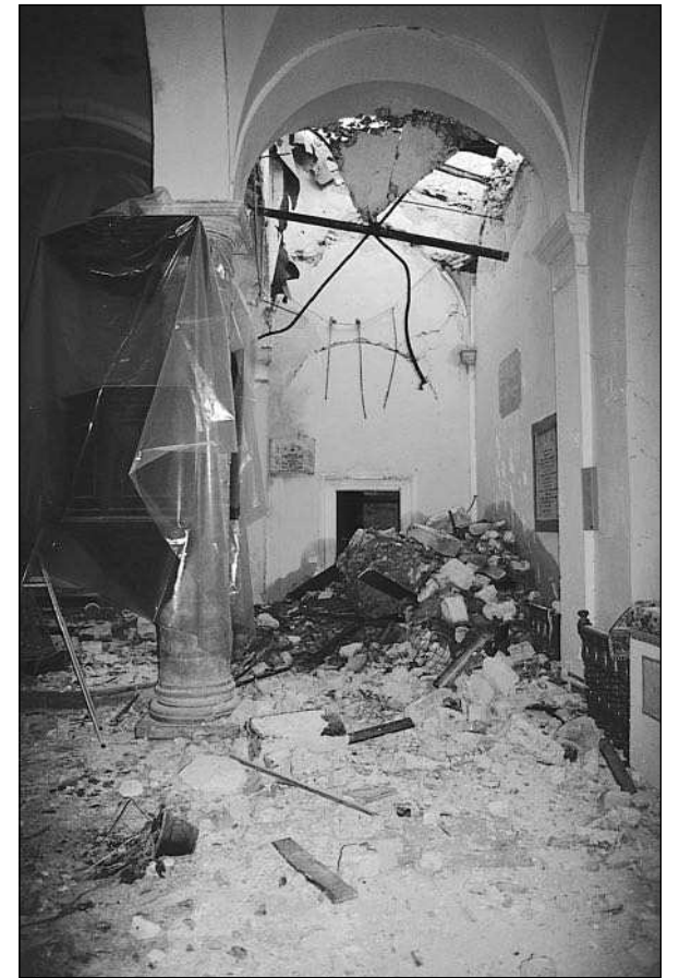
Fig.43 Sellano, chiesa di Santa Maria Assunta: le scosse del settembre-ottobre 1997 hanno causato il crollo di una parte del tetto della navata laterale destra. Questa stessa chiesa subì gravi danni anche per il terremoto del 1791.
