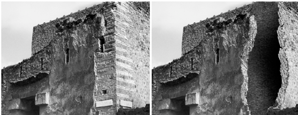
fig. 9 Evidenze di danno a Pompei causato dal terremoto del 62 d.C. dedotto dai restauri di un edificio (a sinistra l'edificio restaurato; a destra come doveva apparire prima del restauro). Angolo e muro laterale di una domus di epoca sannitica ricostruiti in opus mixtum e in opus incertum . Il raccordo fra i due muri doveva essere assicurato da un rivestimento non ancora apposto.
